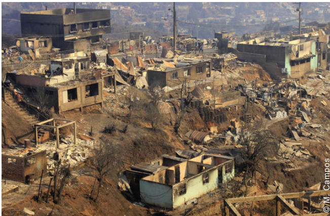
Los incendios en las quebradas de Valparaíso suelen producir grandes daños. En el de abril de 2014 se quemaron barrios enteros. Los mismos sectores fueron afectados por otro incendio en enero de 2017.
